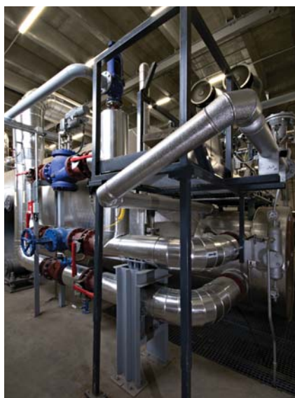
Připojné místo topné vody u kondenzátoru ORC jednotky
