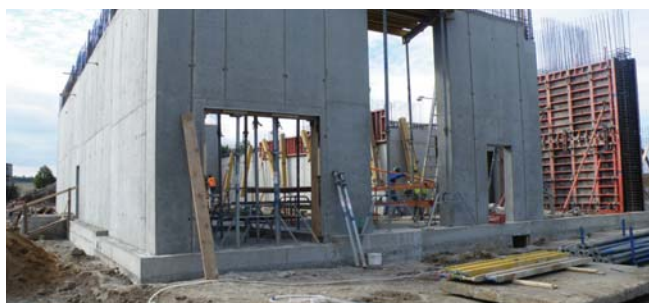
Budoucí kotelna - říjen 2009
