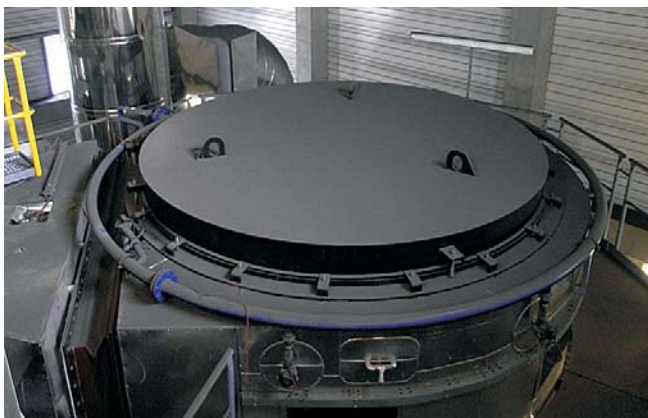
Víko olejového výměníku biomasového kotle
