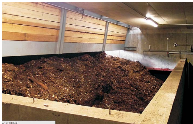
Denní silo biomasy – násypka
