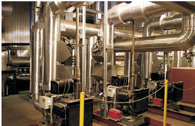
Havarijní okruh s oběhovými naftovými čerpadly primárního okruhu termooleje
