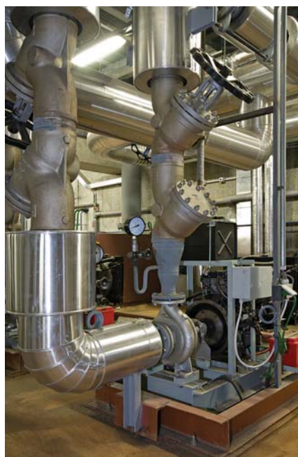
Havarijní čerpadlo termoolejového okruhu
