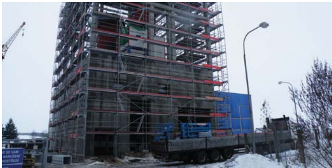
Pohled na kotelnu v lednu 2010
