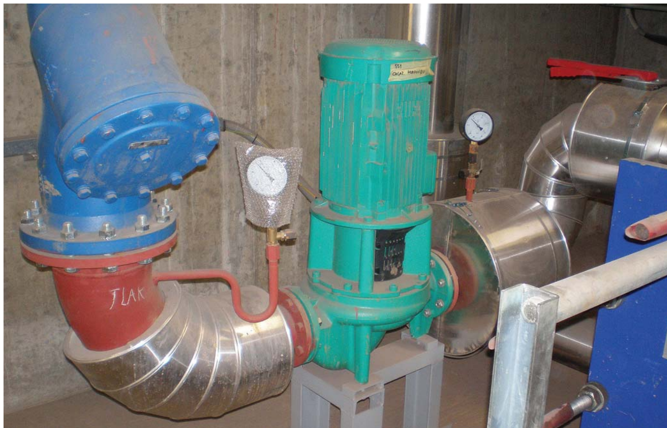
Čerpadlo Wilo-IL v žatecké teplárně
