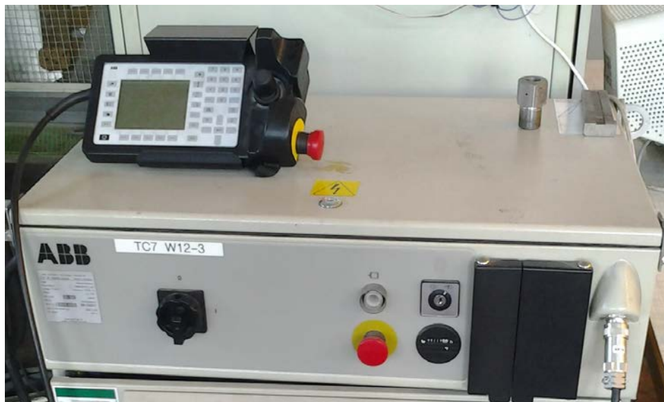
Obr. 1.9-Reální provedení panelu s hlavním vypínačem, pojistným spínačem na klíček a stop tlačítko
