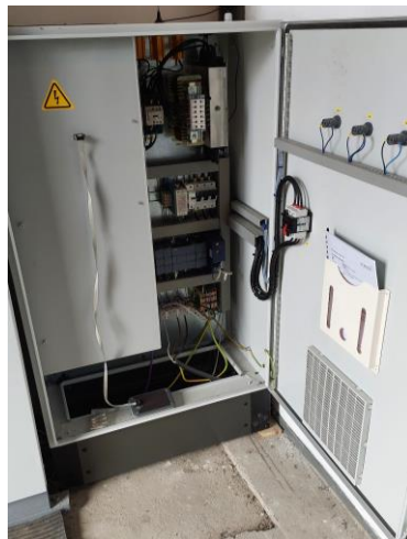
Obrázok 5 Pilotný projekt: inštalácia aktívneho kompenzátora v murovanej TS 22/0,4 kV
